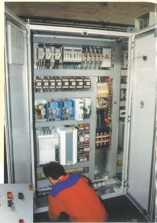
Elektroausrüstung Electric equipment
